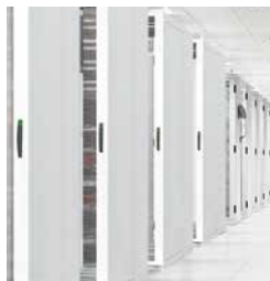
サーバーラック
