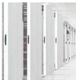
サーバーラック
