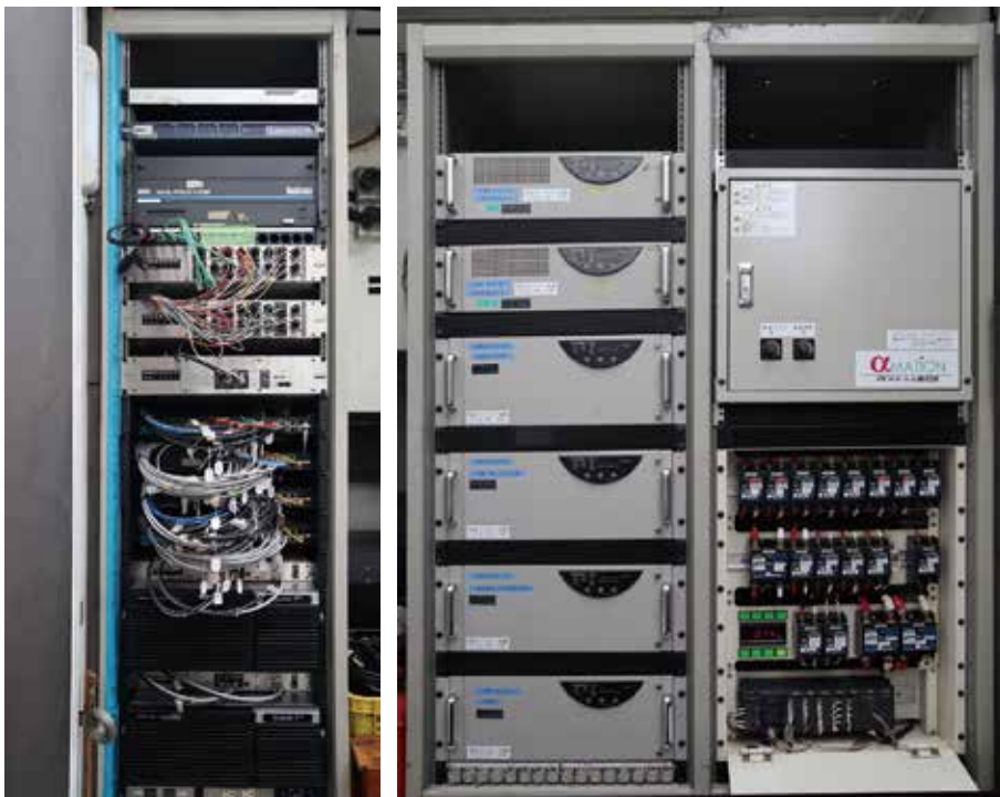
R-4のリアドアを開けるとSystemTのエンジンT80などが格納されている。音声信号は必ず2系統の信号が入る。グレーと黒のケーブルに色分けされている。 右は、停電などが起こった場合、UPSで10分間の電源バックアップができる。
