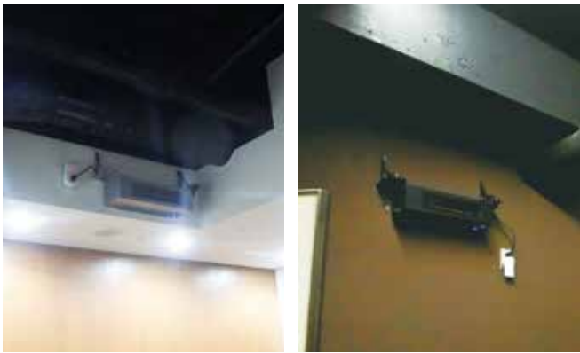
3階の2つの部屋のクライアントスペースに設置されている 「酸素クラスター除菌脱臭装置」
