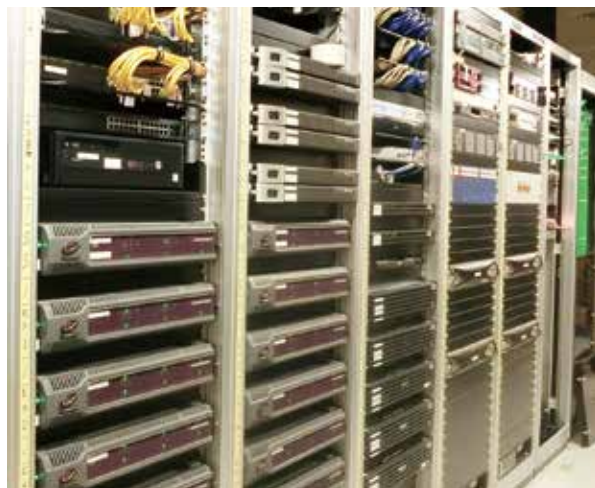
ニュースサブ、スタジオサブ、編集室の共用ラック室
