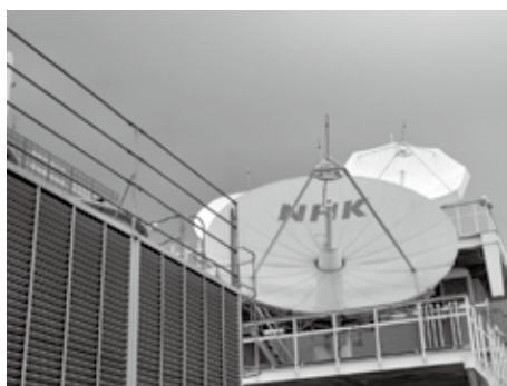
写真2 放送衛星システムは、NHK放送センターの屋上に設置された直径7mのアンテナで8K試験放送用の電波をアップリンクしていた。
