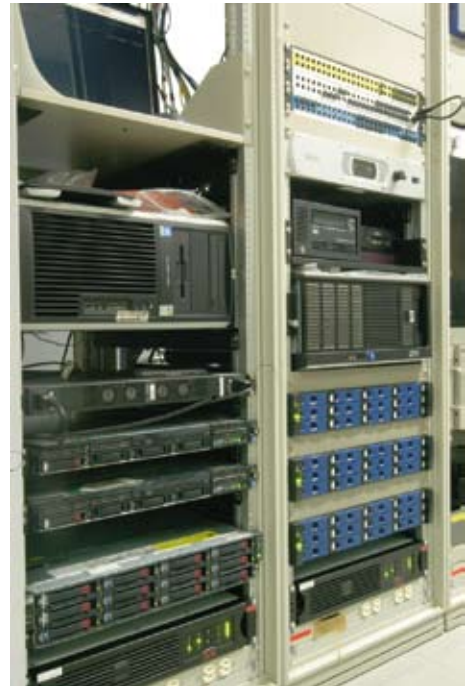
マシンルームのラックに収められた Smoke のハードシステム
