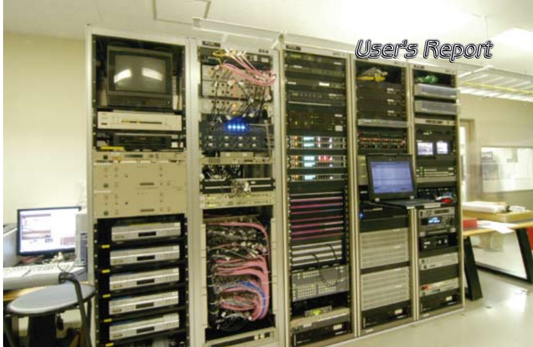
集中マシン室には素材サーバー、送出サーバーを中心に各機材が並ぶ
