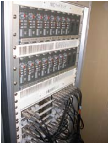
写真4 分配室の常設マイクヘッドアンプ
